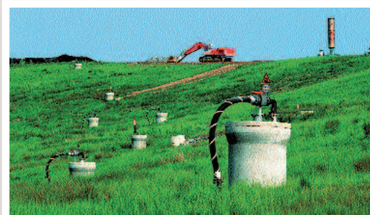
▲ Gasbrunnen im Altbereich der Deponie Außernzell.
