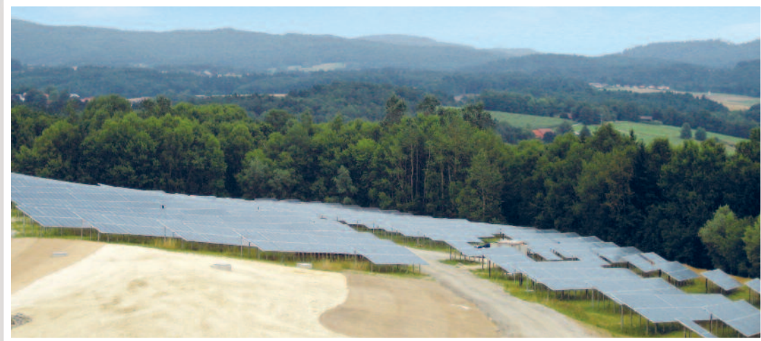
◀ Freiflächen-Photovoltaikanlagen auf der Deponie Außernzell.
